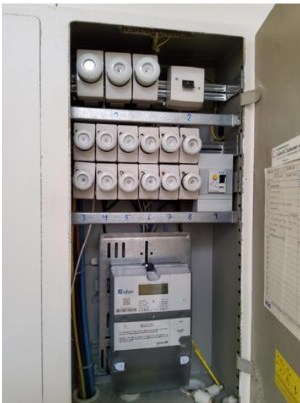
Elektrisk anlegg - [Sikringsskap ]
