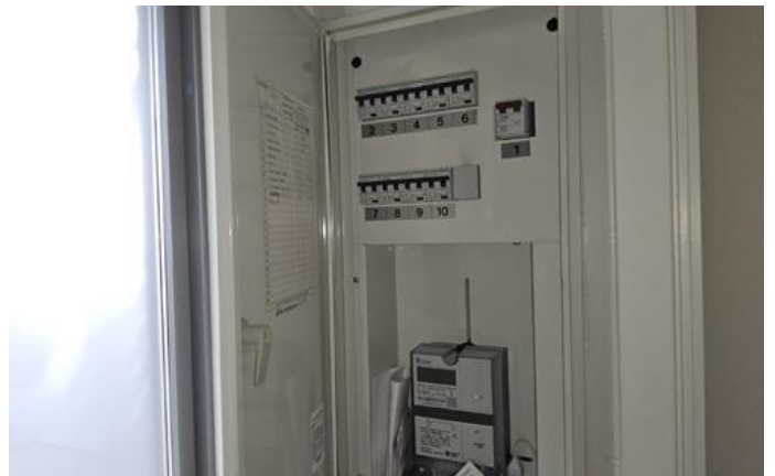
Elektrisk anlegg - [Sikringskap.]
