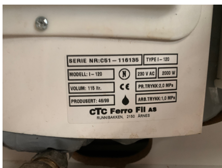
Bereder plassert i kjøkken
