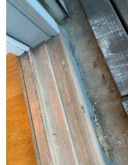
Balkongdøren kniper litt mot terskel
