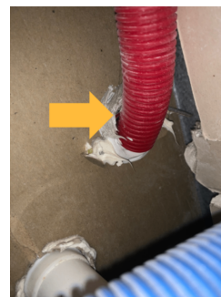
Varerør ikke avsluttet som tiltenkt
