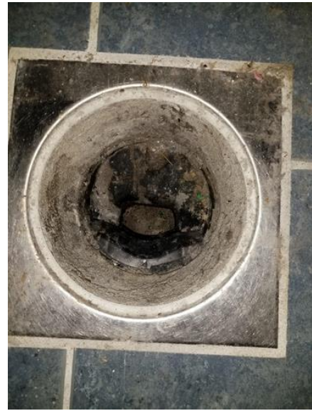
Kommentar - [Sluk vaskerom ]
