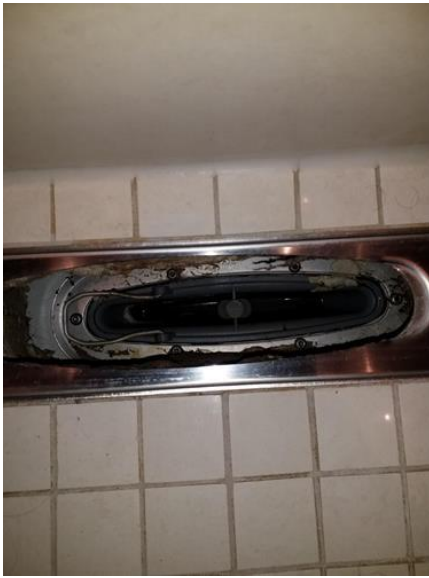
Kommentar - [Sluk bad, 1.etasje ]
