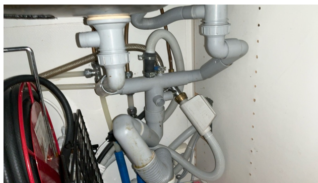
Avløp vask kjøkken
