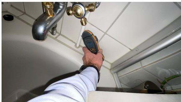
Fuktsøk med Protimeter fuktapparat over badekarkanten.
