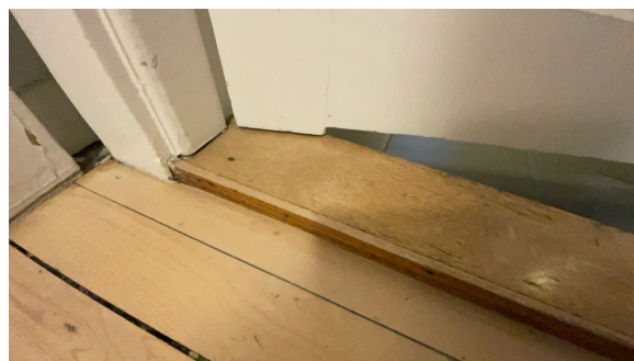
Luftespalte under dørbladet.
