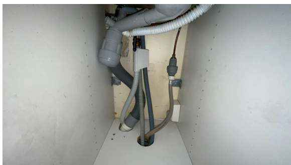
Røropplegg på kjøkken.
