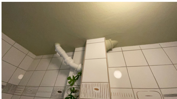
Rørapplegg er dels innkasset på badetrom.
