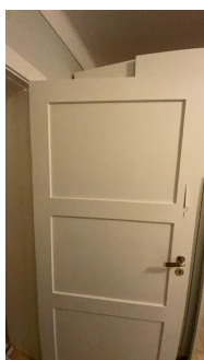
Innerdør. Avskalling på dørbladet.
