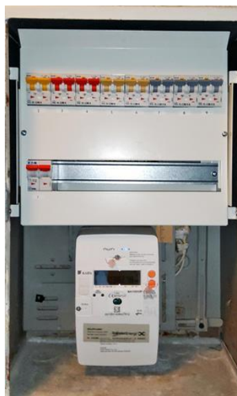
Elektrisk anlegg - [Sikringsskap]
