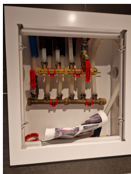
Fordelerskap i hybelbad. Med stoppekraner. Betjener hybelbad og kjøkken.
