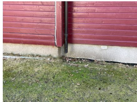
Utløp mot terreng, men uten tilfredsstillende fall.
