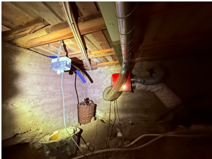
Løse ledninger knyttet til avfukter, som må festes.
