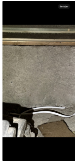
Sprekk registrert i grunnmuren, fra krypekjeller under tilbygget.
