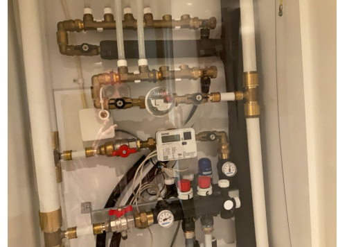
Fordelerskap i bad
