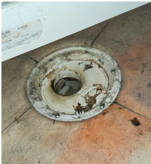
Avløpsrør (ink. sluk) - [Sluk - Bad, 1. etasje]
