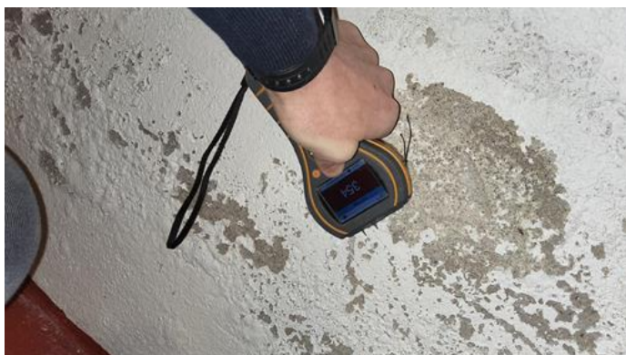
Overflater vegger - [Avsflissing av maling/saltutslag og utslag på fuktindikator - Vaskerom]
