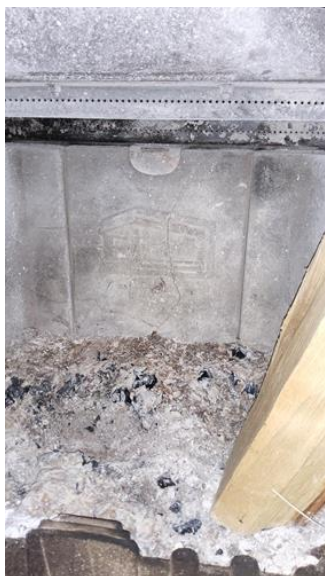
Ildsteder inne i boligen - [Sprekker i steinplate inne i peisens forbrenningskammer]
