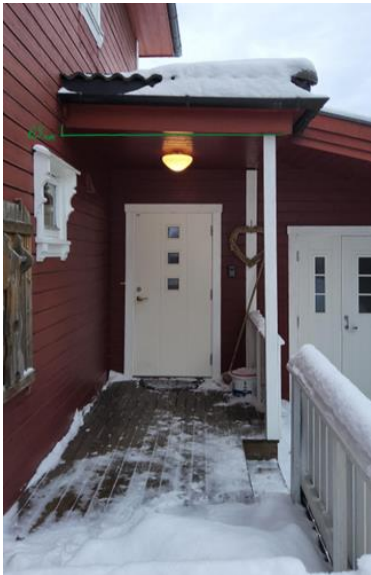
Konstruksjon - [Synlige skjevheter i takkonstruksjonen/overbygget over inngangspartiet]
