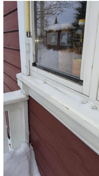
Vinduer - [Manglende vannbord/list i nedre del av vindu på kjøkken]
