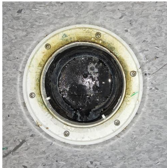
Avløpsrør (ink. sluk) - [Sluk - Bad, 2. etasje]
