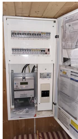
Forenklet vurdering av det elektriske anlegget - [Sikringsskap]
