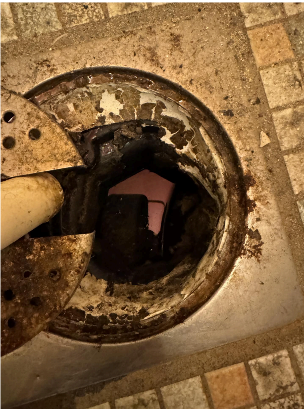
Opprinnelig sluk. Forhold knyttet til membran/tettesjikt er uoversiktlig og ikke synlig.
