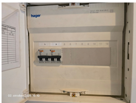
Sikringskap i leiligheten
