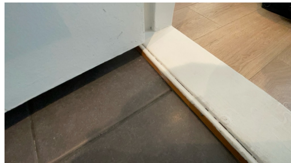
Luftespalte under dørrbladet.
