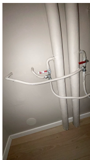
Rørstrek og stoppekraner i innvendig bod.
