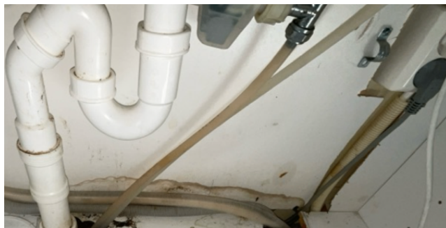
Rør på kjøkken.
