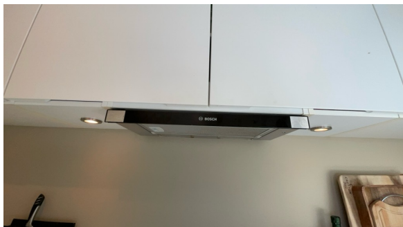
Kjøkkenventilator med kullfilter.
