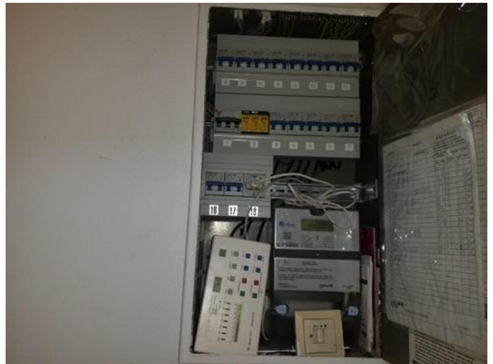
Elektrisk anlegg - [Sikringskap.]
