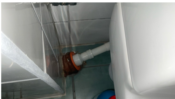
Originalt avløpsrør på badetrom.
