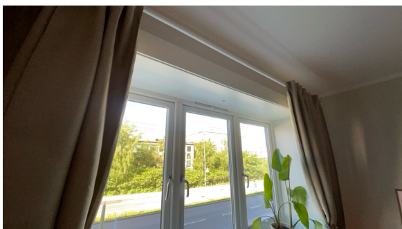
Luftespalte over vindu.
