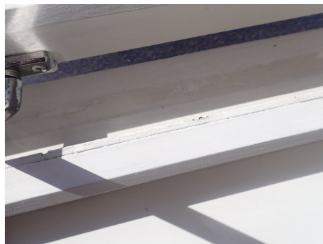
Det er skadet pakninger på flere vinduer.
