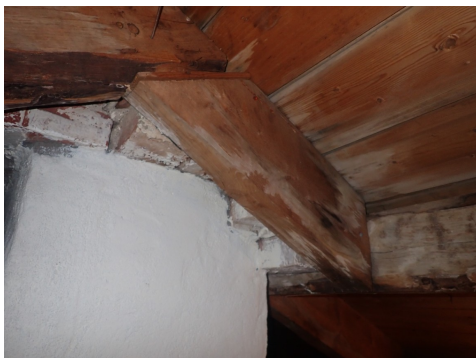
Det er påvist skjolder i undertaket rundt pipe.
