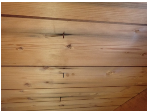
Det er synlig spikerender gjennom undertaket.
