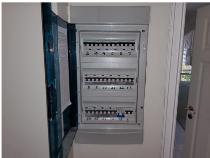
Elektrisk anlegg - [Sikringsskap. ]
