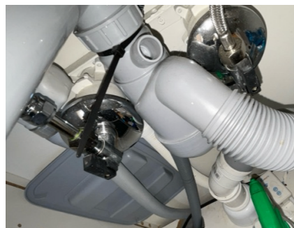
Lekkasjesensor i bunn av underskap.
