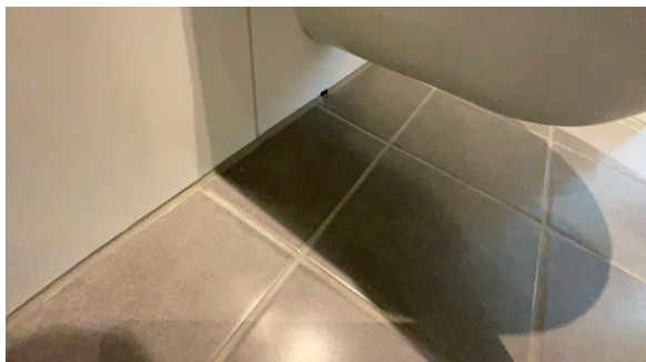
Synlig drencspalte under toalettet.
