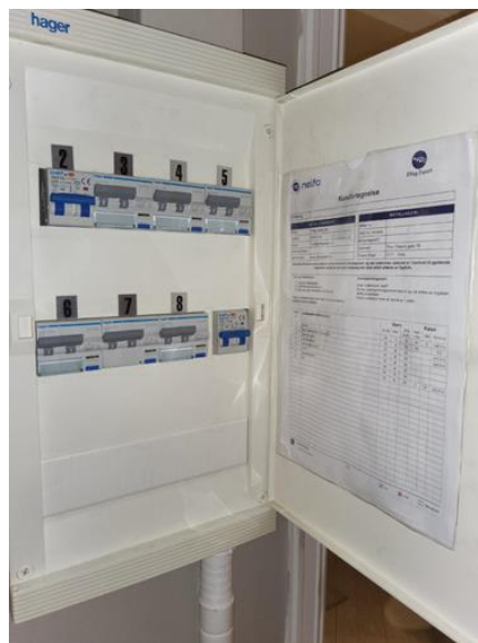
Elektrisk anlegg - [Sikringskap]
