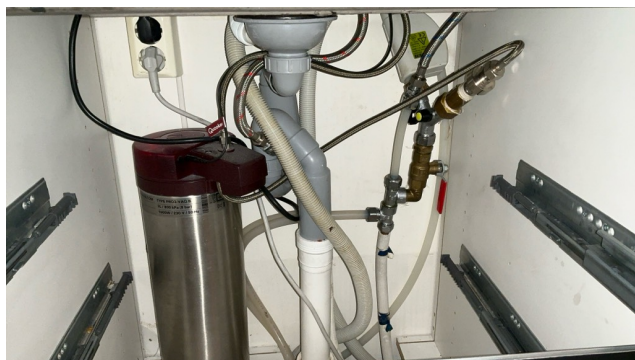
Avløp vask kjøkken
