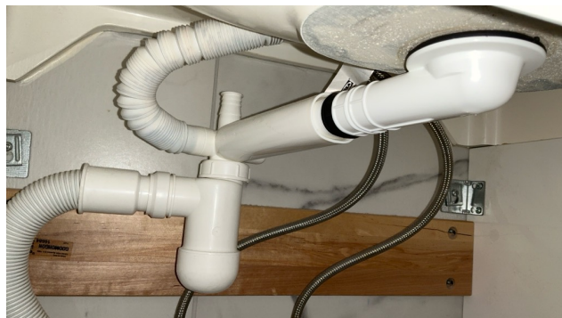
Avløp servant bad
