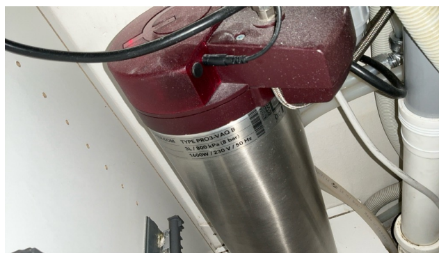
Quooker varmtvann på kjøkken
