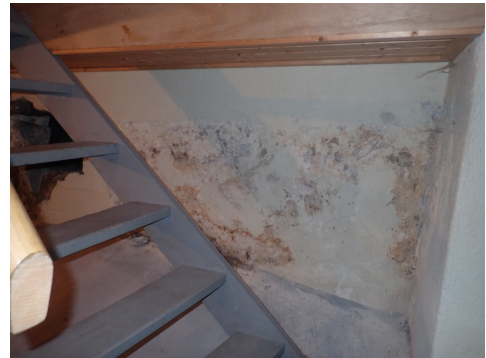
Stedvis saltutslag i kjeller gulv/overgang vegg.
