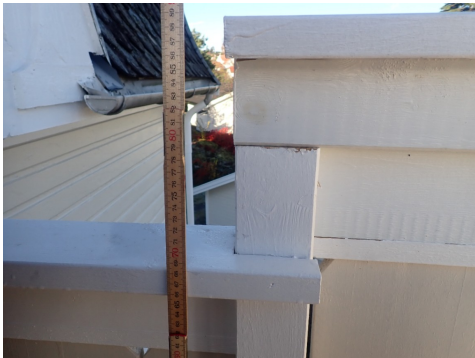
Deler av rekkverk er lavt. Under 70 cm.
