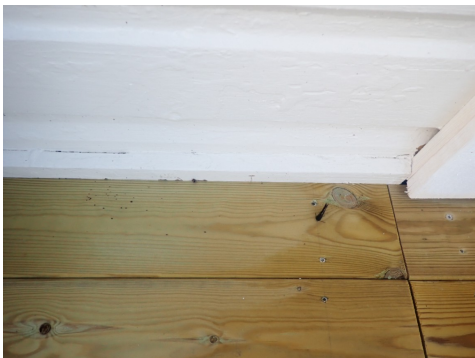
Terrassebord er lagt helt inntil yttervegg. Dette vanskeliggjør vedlikehold av gulv og vegg.
