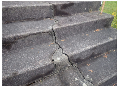
Det er påvist sprekker i trapp
