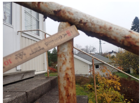
Rekkverk er skadet.
