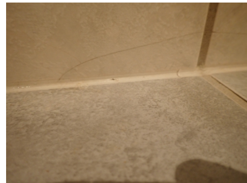
Iere fliser har sprukket
