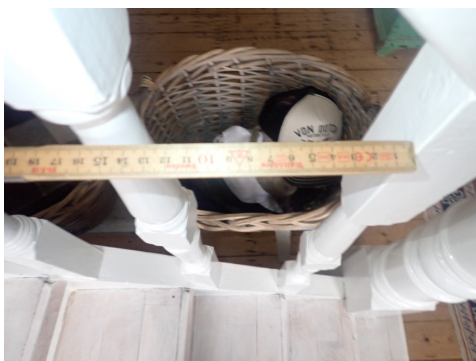
Åpninger i rekkverk er over 10 cm
