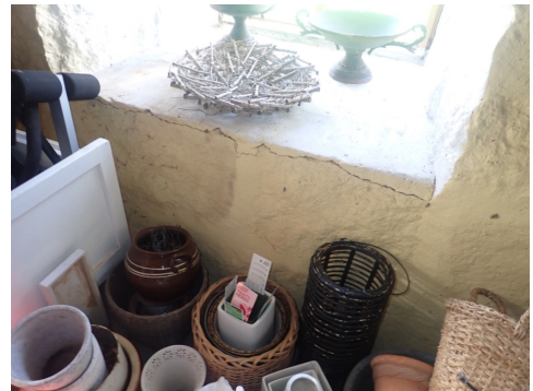
Sprekk i grunnmur .
