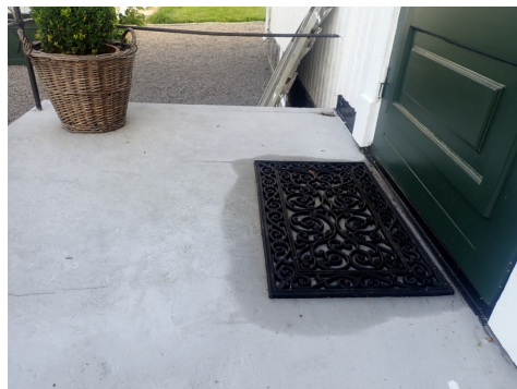
Gulv på trapp har fall innover mot yttervegg. Vann og fukt fra gulvet har påvirket yttervegg og kjeller i området.
