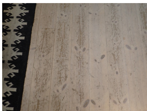
Synlig slitasje på gulv kjøkken.
