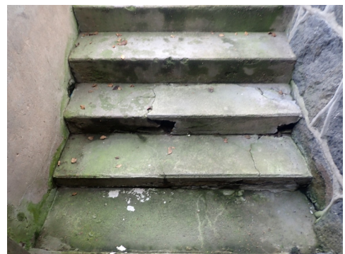
Trapp til kjeller har sprekker.
