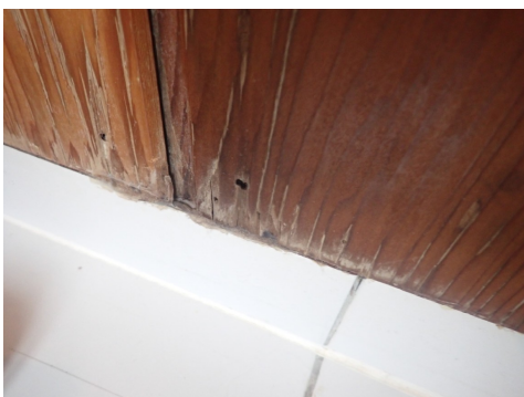
Vegg er preget av tidligere dusjing direkte på trepanelområdet fra tidligere dusjområde.
