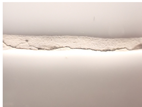
Riss i fuge mellom nedre fliser på vegg i dusj mot gangen.
