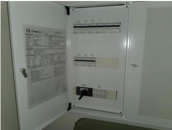
Elektrisk anlegg - [Sikringskap ]
