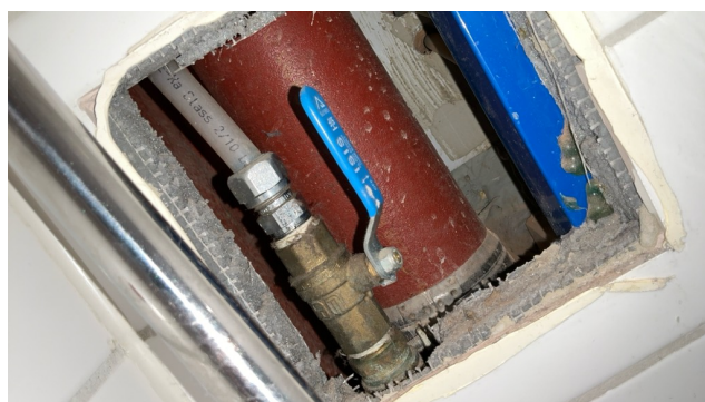
Hovedstoppekran bak luke i vegg ved toalett
