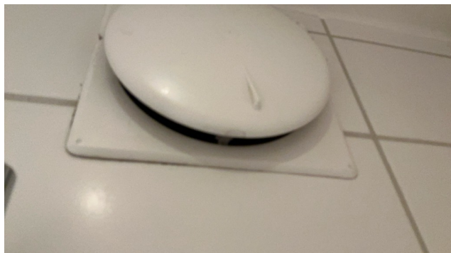
Avtreksventil. Bør byttes til tallerkenventil for bedre effekt
