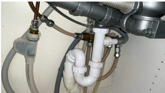
Avløp vask kjøkken
