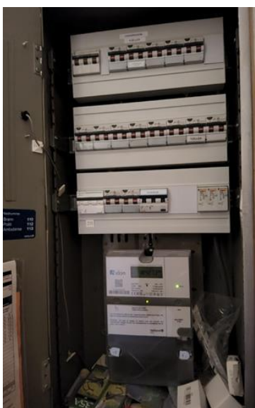
Elektrisk anlegg - [Sikringskap ]
