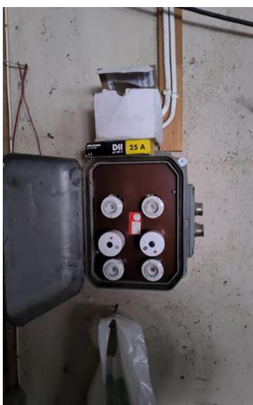
Elektrisk anlegg - [Sikringskap garasje ]
