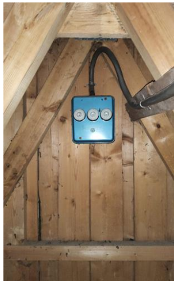
Elektrisk anlegg - [Hovedsikring på loft]
