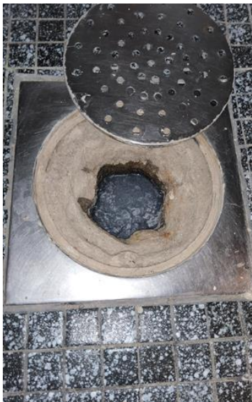
Avløpsrør (ink. sluk) - [Sluk på bad 1.etasje ]
