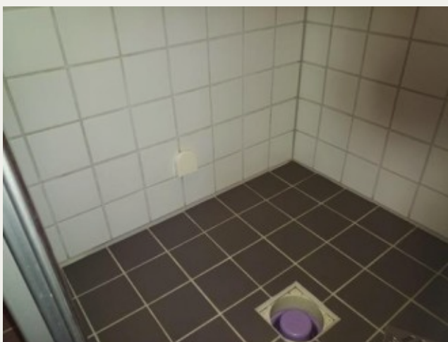
Kommentar - [Rørgjennomføring i dusjone.]
