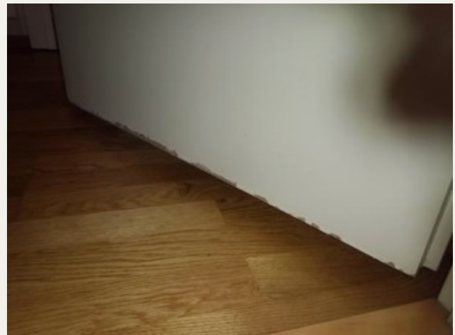
Kommentar - [Fuktskade på badersdør.]
