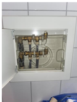
Vannrør - Fordelerskap vannbåren varme.
