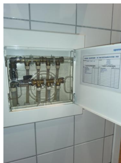
Vannrør - Fordelerskap vannrør
