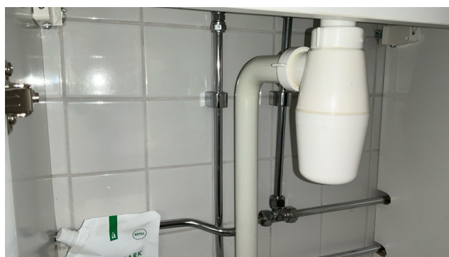
Avløp servant bad
