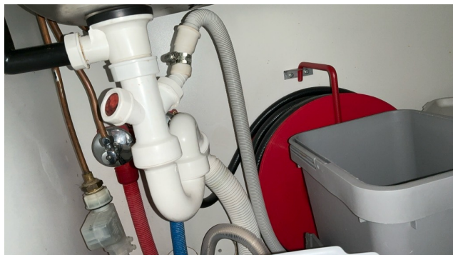
Avløp vask kjøkken
