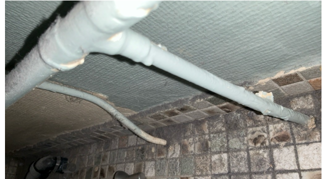
Tilførsel vann bad. Uten stoppekraner.
