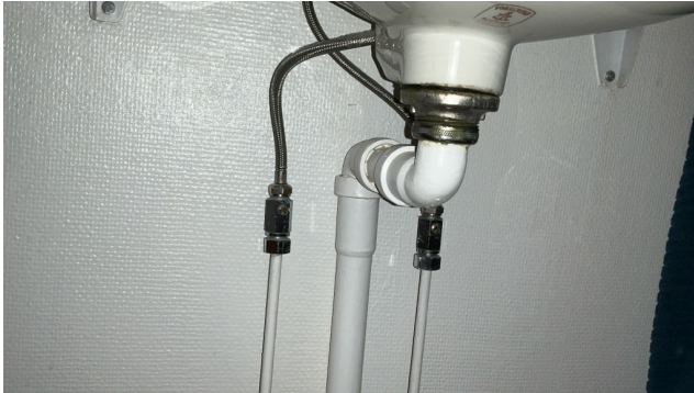
Avløp servant bad
