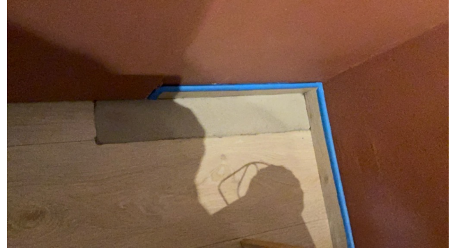
Lite område i entre der det ikke er lagt laminat. Merk også at det under oppvaskmaskin ikke er lagt laminat.
