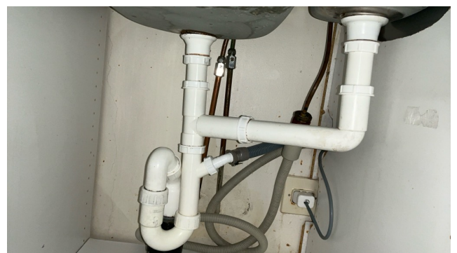
Avløpsrør vask kjøkken
