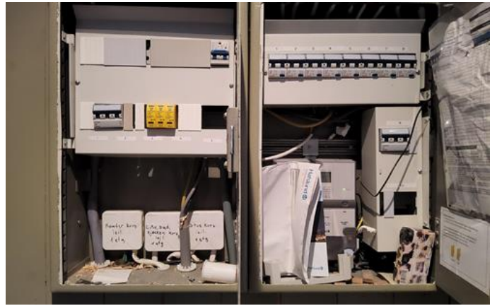
Elektrisk anlegg - [Sikringskap. ]
