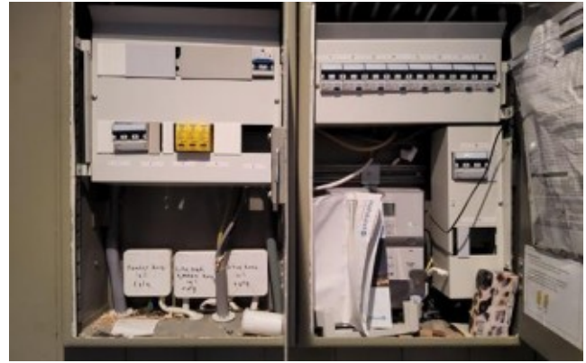
Elektrisk anlegg - [Sikringskap. ]
