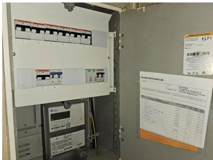
Elektrisk anlegg - [Sikringsskap og kursfortegnelse ]
