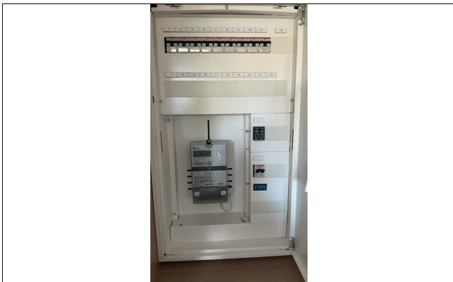
Sikringskap med strømmåler
