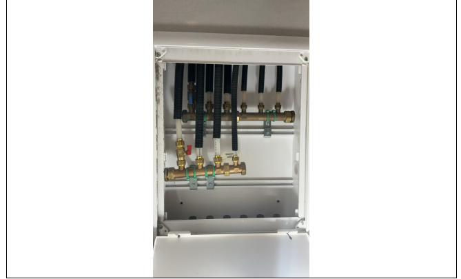
Fordelerskap for rør-i-rør
