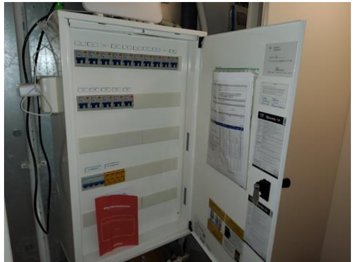
Elektrisk anlegg - [Sikringsskap.]
