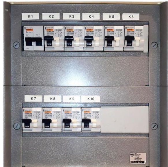
Elektrisk anlegg - [Sikringskap]
