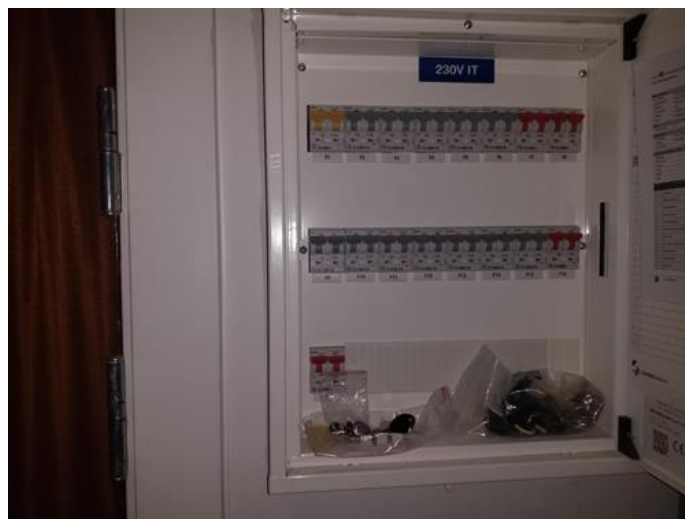
Elektrisk anlegg - [Sikringsskap. ]
