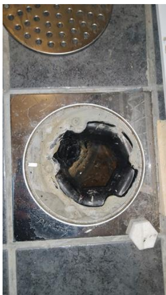
Våtrom - [Sluk vaskerom]
