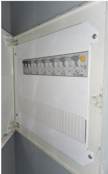
Elektrisk anlegg - [Sikringsskap ]
