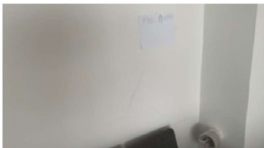
Sprekk/skade i vegg
