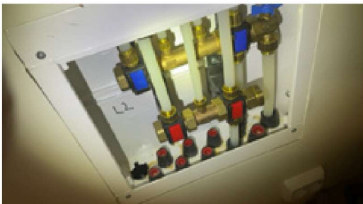
Fordelerskap for vannrør
