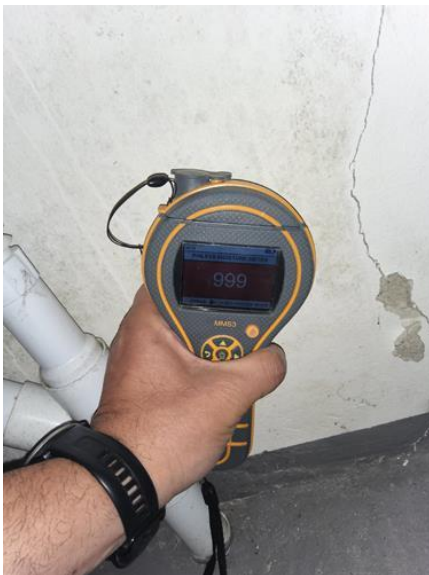
Fukt i tilleggende konstruksjoner - [Overflatefuktsøk vaskerom ]
