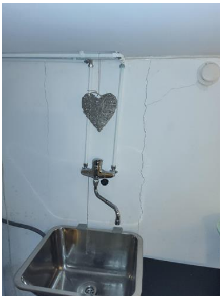
Helhetsvurdering - [Sprekker på vegger vaskerom ]
