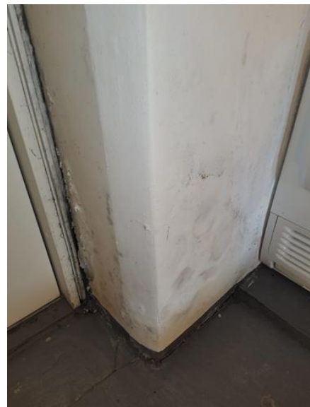
Helhetsvurdering - [Fuktrelaterte skader på vegger vaskerom. ]
