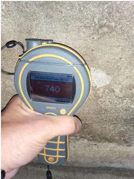
Helhetsvurdering - [Fuktutslag på yttervegger i kjelleretasje ]
