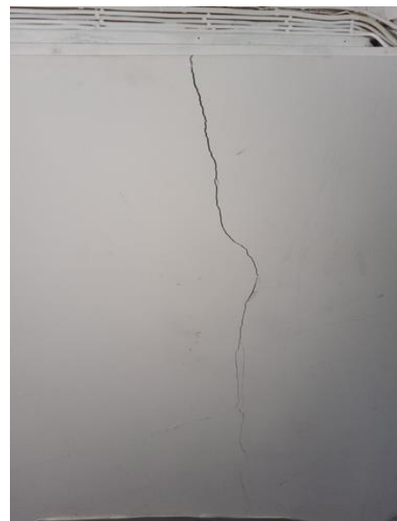
Grunnmur - [Riss/sprekker på grunnmur. ]
