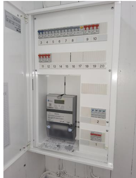
Elektrisk anlegg - [Sikringskap ]
