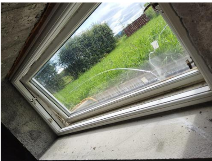
Vinduer - [Punktert glass vindu i kjelleretasje. ]
