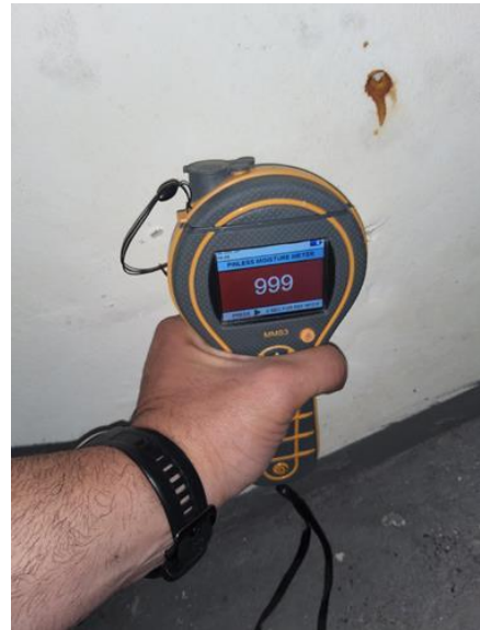
Helhetsvurdering - [Fuktutslag på yttervegger i kjelleretasje ]
