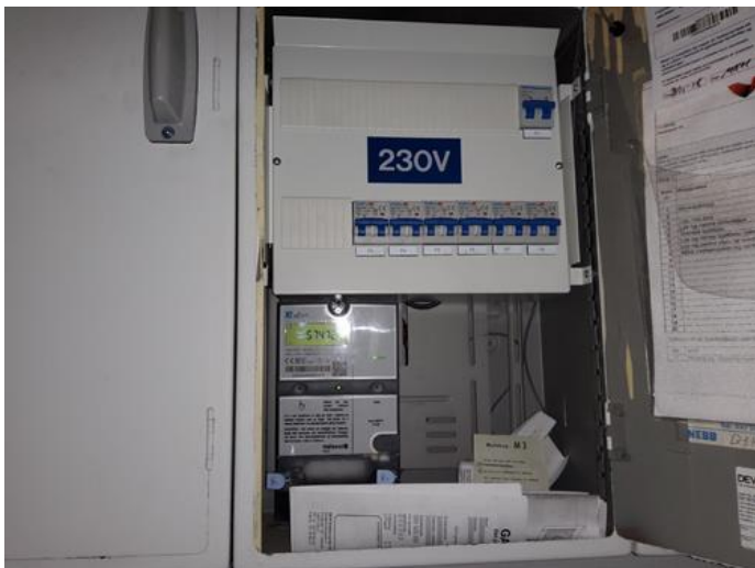
Elektrisk anlegg - [Sikringskap]
