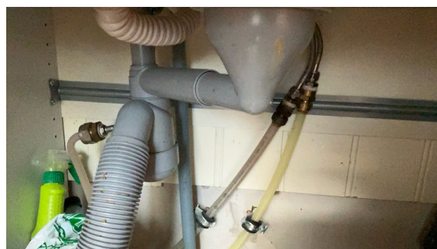
Avløp vask kjøkken
