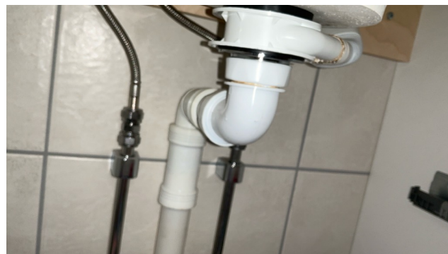
Avløp servant bad
