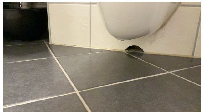
Drensspalte underside systerne kasse
