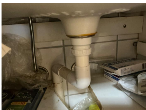
Avløp servant bad
