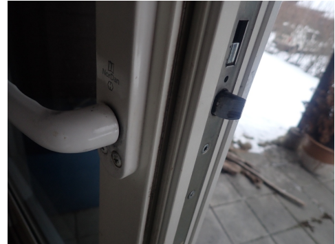
Vrider er defekt på terrassedør fra stue
