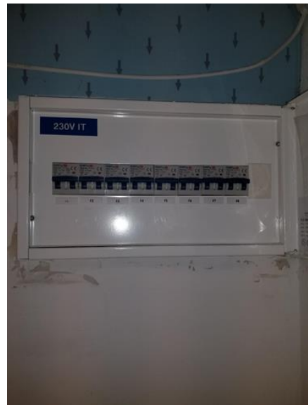
Elektrisk anlegg - [Sikringsskap kjeller hoveddel]
