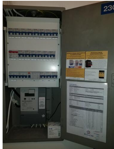
Elektrisk anlegg - [Sikringsskap 1.etasje]
