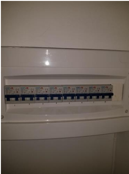
Elektrisk anlegg - [Sikringsskap hybel]
